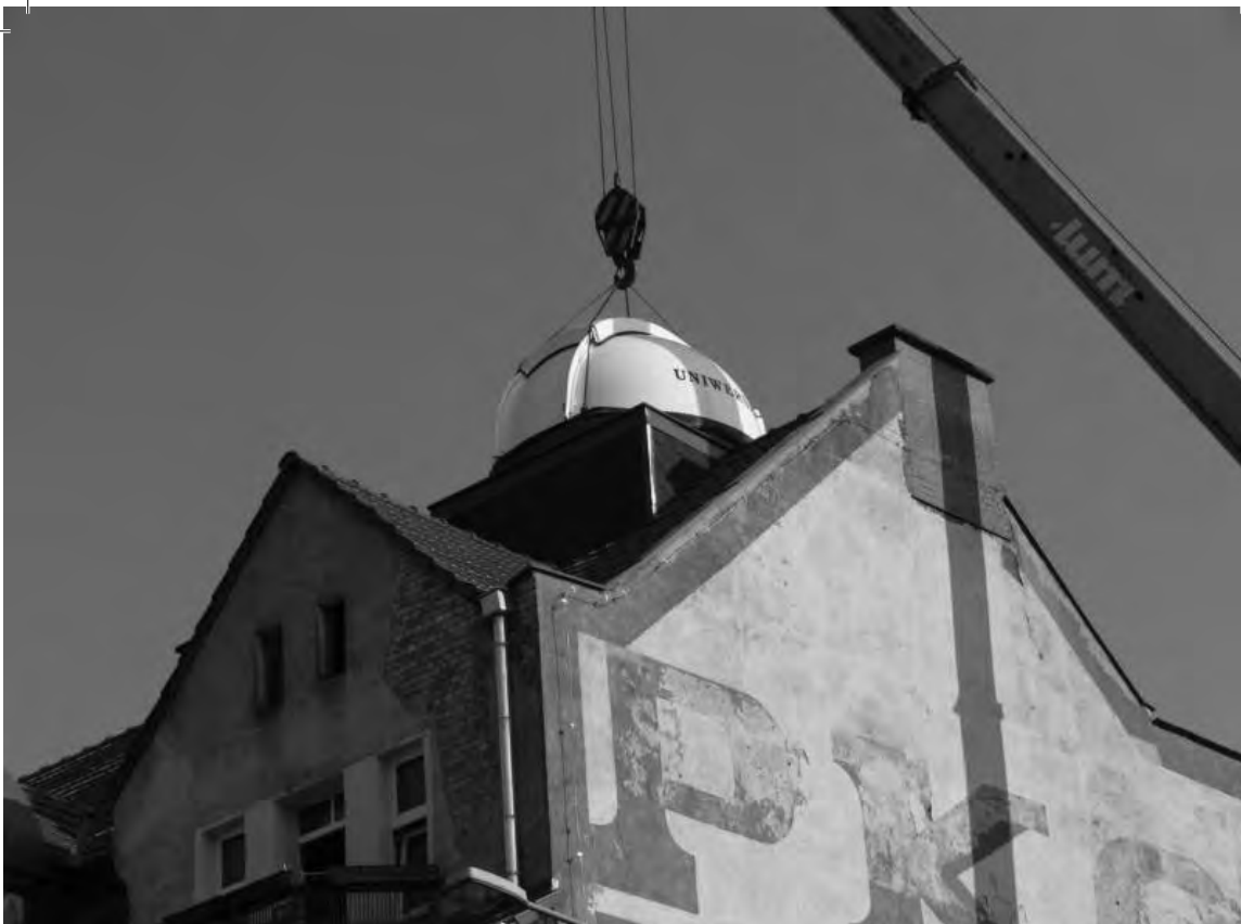
Montage der Observatoriumskuppel am 11. Juni 2007 Montaż kopuły obserwatorium w dniu 11 czerwca 2007 r.
